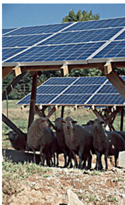
Abb. 3: Solarkraftwerk Sonnen (Quelle: Voltwerk AG)
