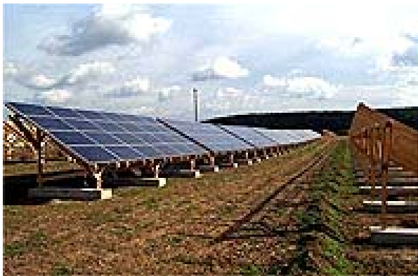
Abb. 2: Solarkraftwerk Markstetten (Quelle: Voltwerk AG)
